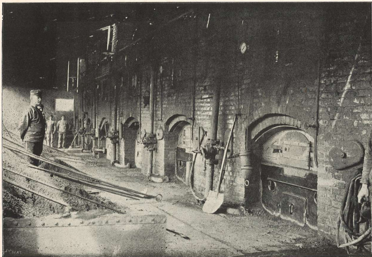
Batterie de 7 chaudières avec le Foyer Meldrum, à la Société Cockerill, à Seraing, à l'Houillère Colard.
