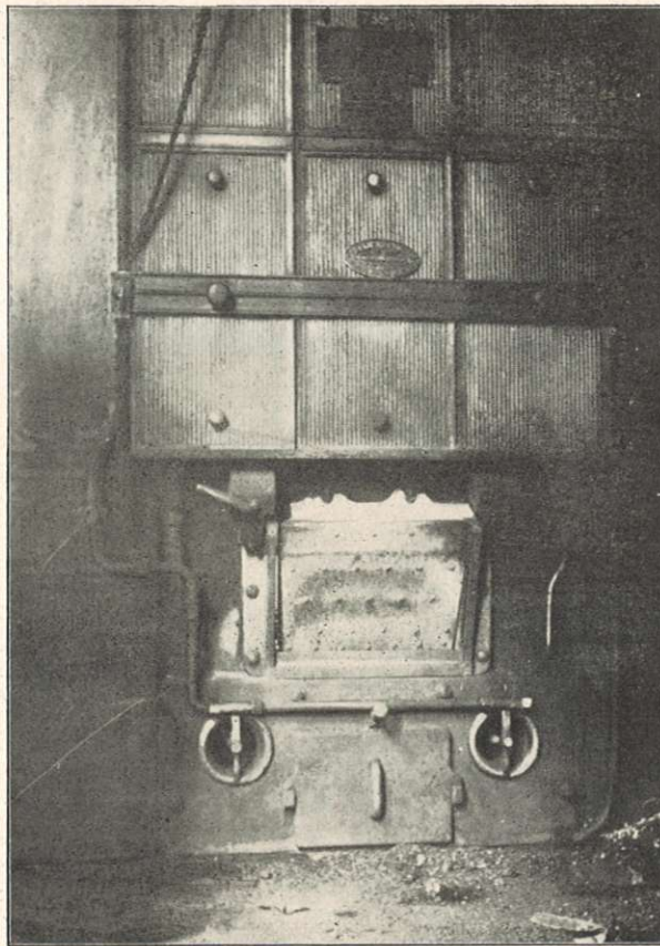
Chaudière Niclausse, munie de Foyer Meldrum, à l'usine de la Maison Bréguet, à Paris.
