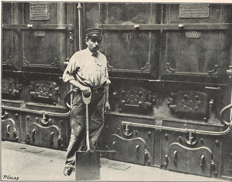
Chaudières Niclausse munies de Foyers Meldrum à la Tour Eiffel.
