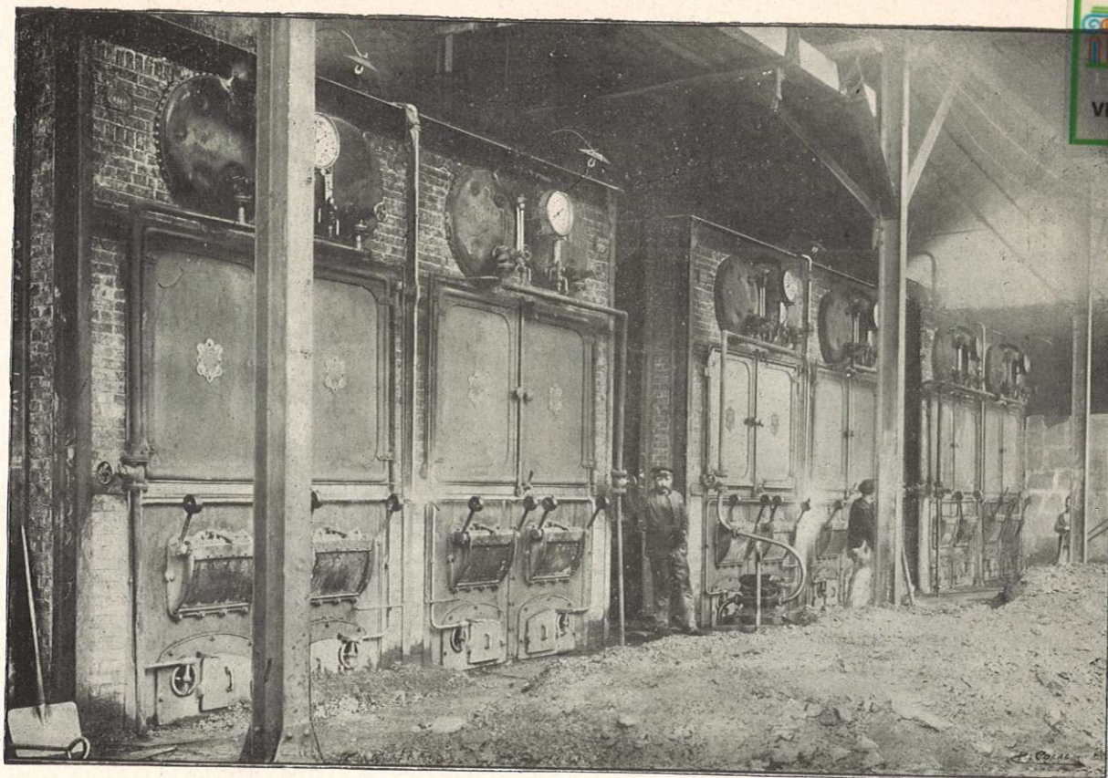
Vue de 6 Chaudières Babcock et Wilcox à l'usine de Javel, à Paris, de la Société des Aciéries de France, munies de Foyers Meldrum.
