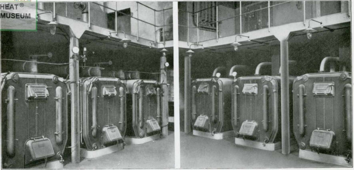
Fig. 2. 3 chaudières a vapeur à basse pression et 3 chaudières à eau chaude.
