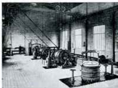
POSTE DE SURPRESSION
