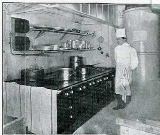
Fig. 5. — Restaurant "LES WIKINGS" Fourneau comportant un bain-marie. Au fond, on voit le chauffe-eau à accumulation.
