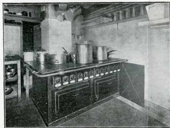
Fig. 1. — Bar Presto-Bourse. Fourneau de 38 l.w.
