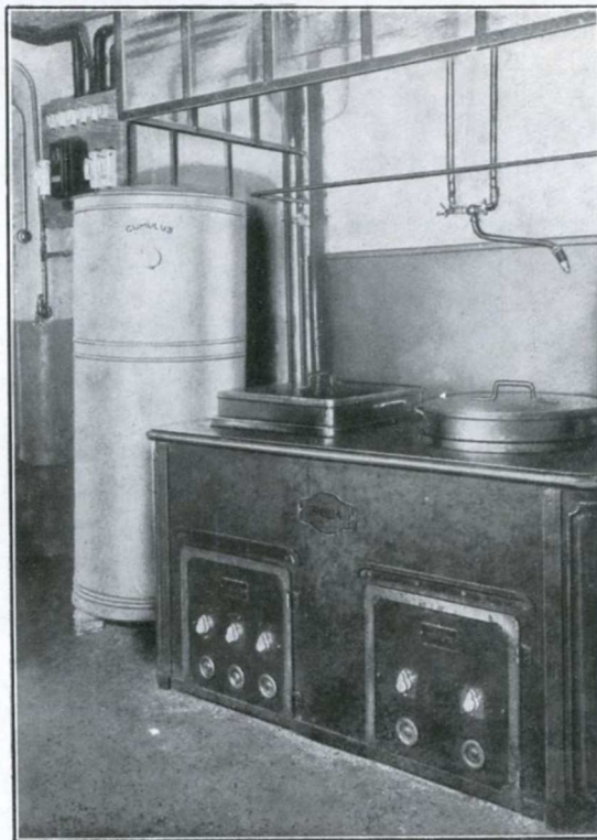
Fig. 3. — Charcuterie Janisson, rue de Lancry. Le fourneau et le chauffe-eau.
