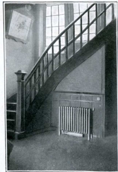
Fig. 6. Radiateur électrique à circulation d'eau installé dans le vestibule de la villa représentée figure 1.
