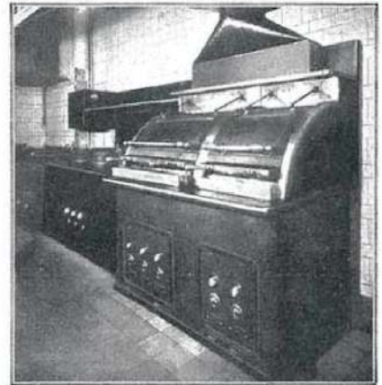
Le gril et la friteuse des cuisines du Colisée. M. Sidis, architecte.
