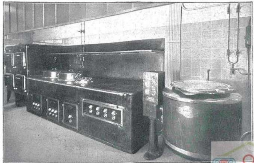
Les cuisines des Grands Magasins Prisunic, à Paris. De gauche à droite, les deux fours à deux chambres, le fourneau et la marmite basculante de 150 litres. — M. Wybo, architecte.
