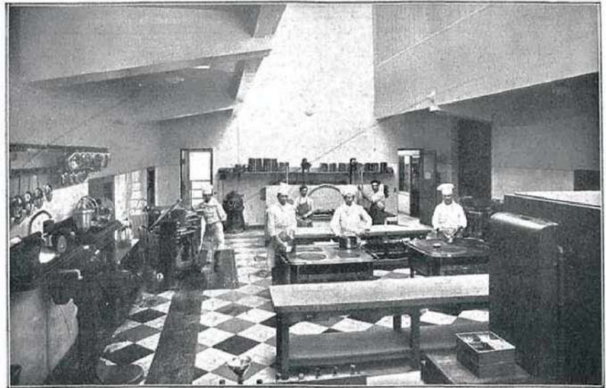
Vue générale de la cuisine électrique des usines Edgar Brandt, à Châtillon-sous-Bagneux. Au centre, les fourneaux. Au fond, à gauche, les marmites de 200 litres ; à droite, en partie masquées par un cuisinier, les marmites de 100 litres. — MM. Plooney et Cassan, architectes.
