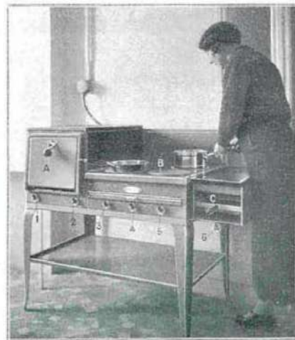
Fig. 3. — Type des cuisinières électriques installées dans l'immeuble moderne d'Issy-les-Moulineaux.
