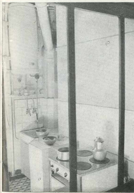
Fig. 3. — Une cuisine de l'immeuble 84, rue de l'Assomption. M. Gaston Ernest, Architecte. On remarque une cuisinière électrique à 4 plaques, un four et un chauffe-assiette. Fixé au mur, au-dessus de l'évier, un chauffe-eau électrique à accumulation.
