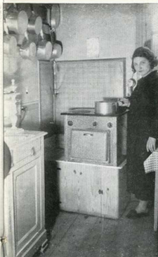
Fig. 3. — Cuisinière simplifiée sans pieds comportant un four et deux plaques chauffantes. Cette installation est réalisée à Saintes.
