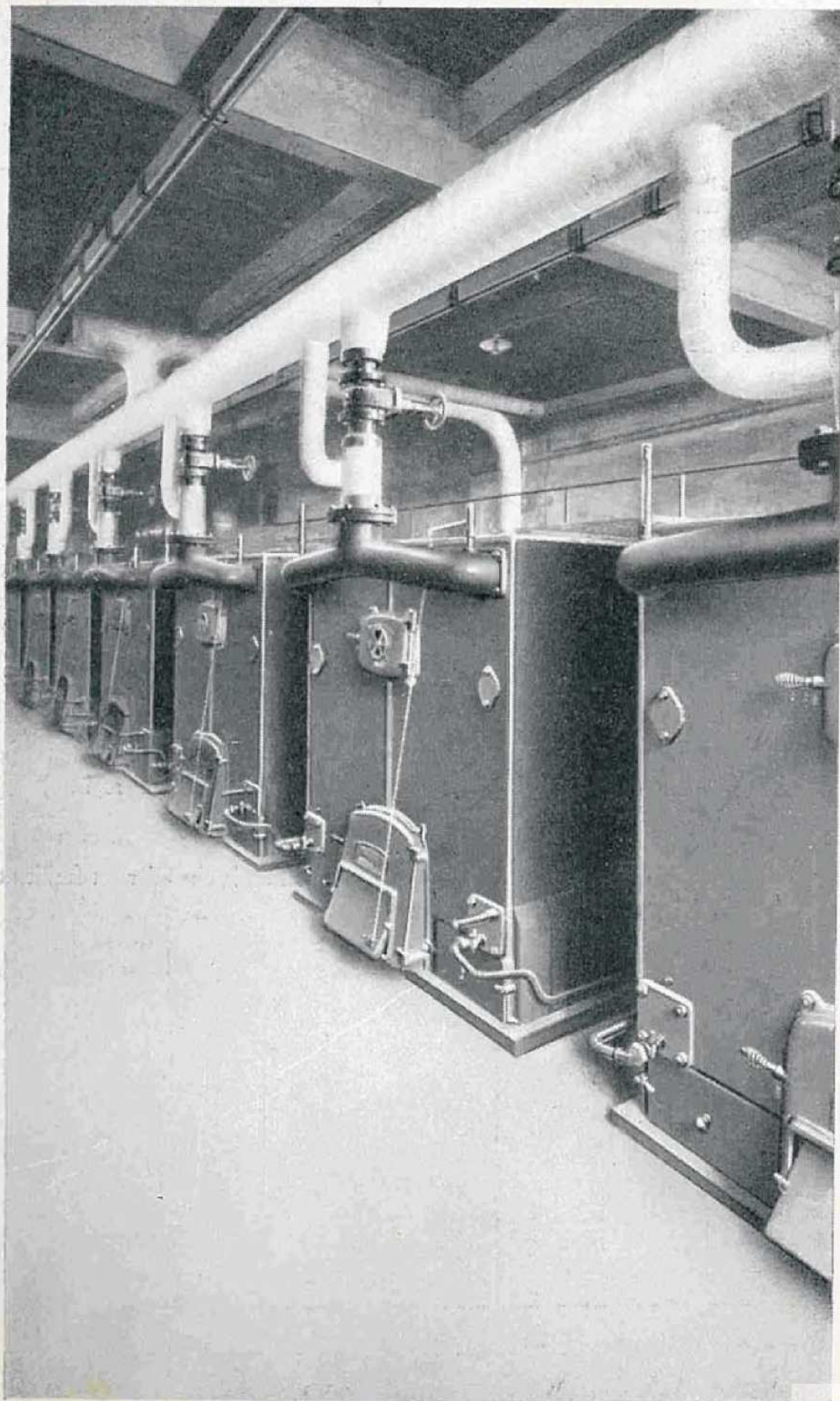
Batterie de chaudières « DE DIETRICH » Chaufferie de l'hôpital de Belfort.
