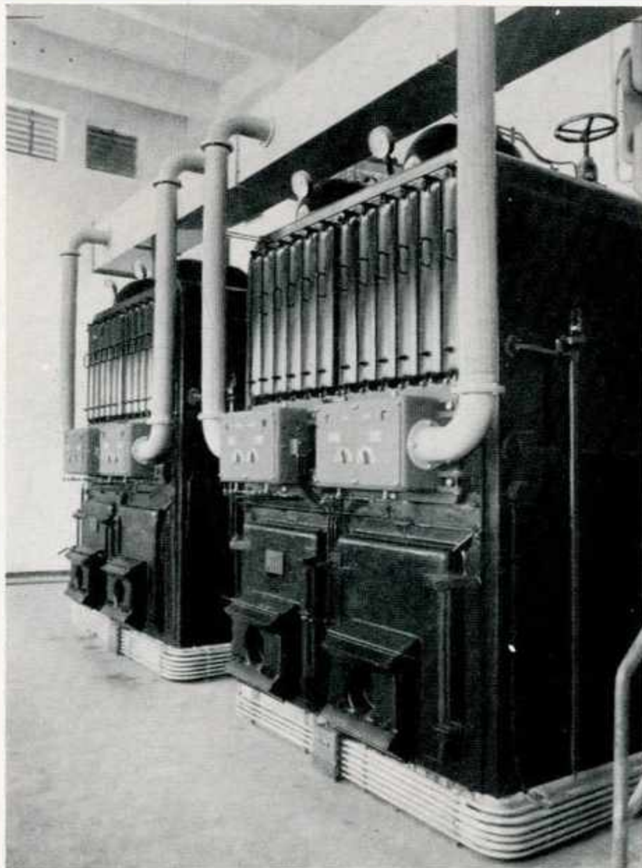
Figure 48. Deux chaudières à poches d'eau Sulzer de 125 m 2 de surface de chauffe fonctionnant au moyen de deux brûleurs jumelés Oertli entièrement automatiques, consommant des déchets d'huile de moteur d'avion mélangés à du mazout industriel III. (Texte, page 62.)
