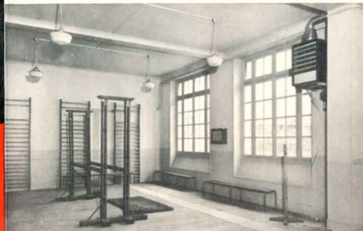
Salle de gymnastique : sol entièrement dégagé grâce à un aérotherme série L.
