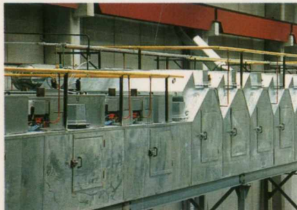
Polymérisation de poudres sur tôle aluminium (coil coating).
